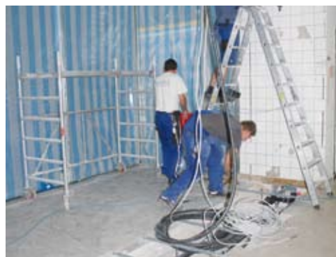
Ende Juni war noch der Boden aufgestemmt, um alle Versorgungsleitungen zu legen.
