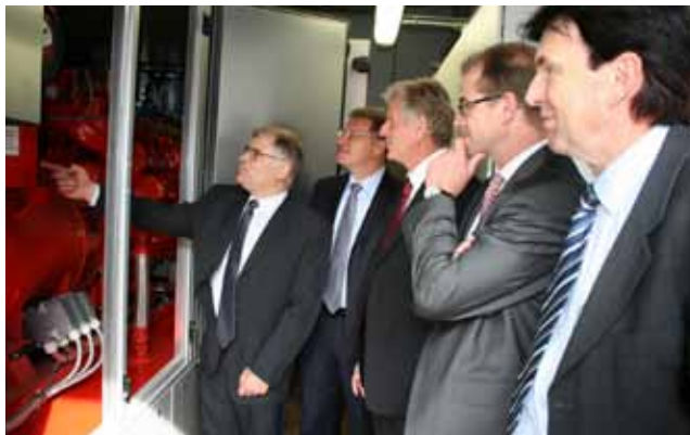
v.l.: Georg Kroack, stellvertretender Leiter der Technischen Abteilung der Klinikum Bayreuth GmbH gibt Jürgen Bayer, Roland Ranftl, Dr. Alexander Fenzl und Werner Dehmel einen Einblick in die technischen Details der modernen, umweltschonenden Kraft-Wärme-Kopplungsanlage.
